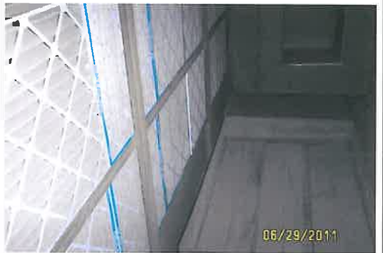
HVAC Unit NE Side
